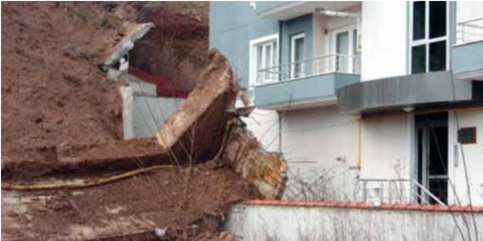
Heyelan sonucu bir inşaatın 10 metrelik istinat duvarı çöktü
