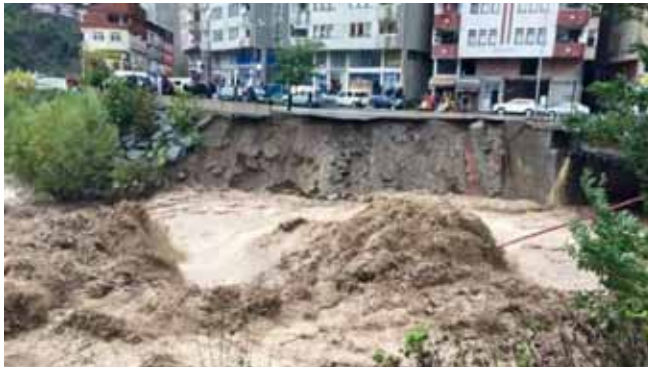
Sel suları yol kenarın aşındırdığı karayolu ve araçlar için tehlike yarattı
