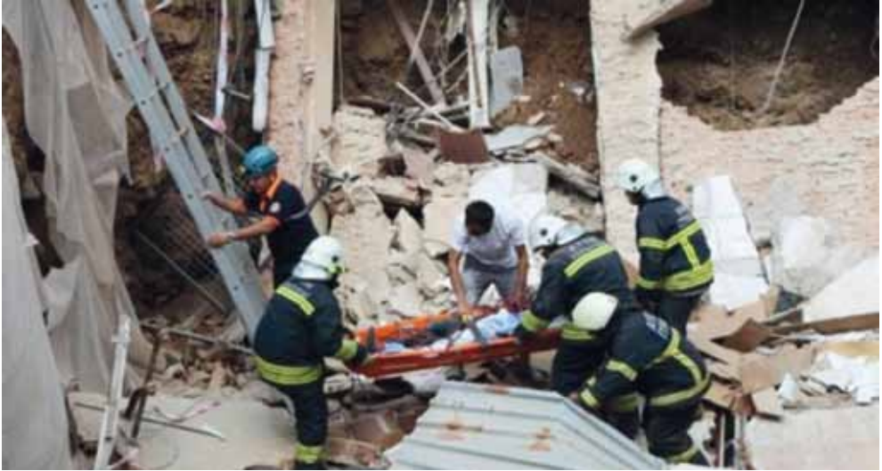
Göçük altında kalan vatandaşın kurtarılma çalışmaları
