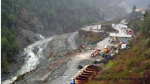
Baraj inşaatındaki heyelan
