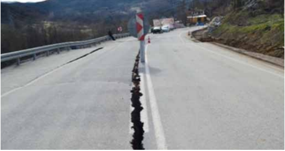
Yolda oluşan derin çatlaklar
