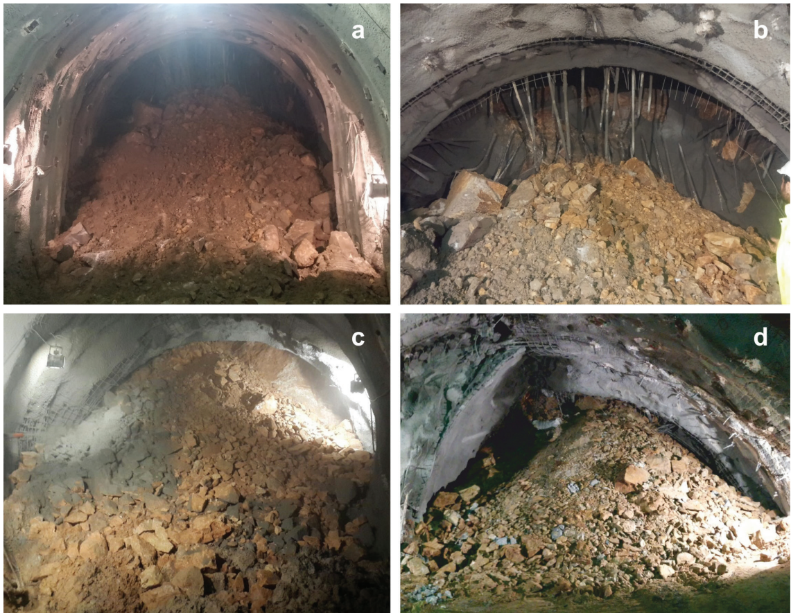
Şekil 8. Tünellerde gelişen aşırı sökülme sonrası ayna görüntüleri a) Yaklaşım tüneli km:0+286, b) Yaklaşım tüneli km:0+291, c) Yaklaşım tüneli km:0+308, d) T2 tüneli km:0+935.
